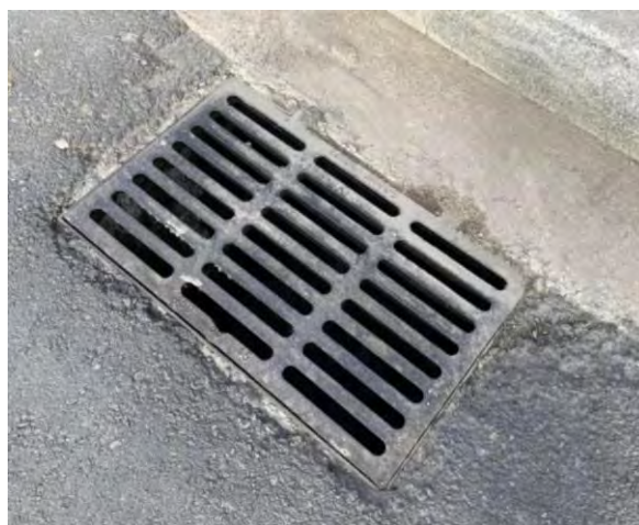
改造后雨水井
